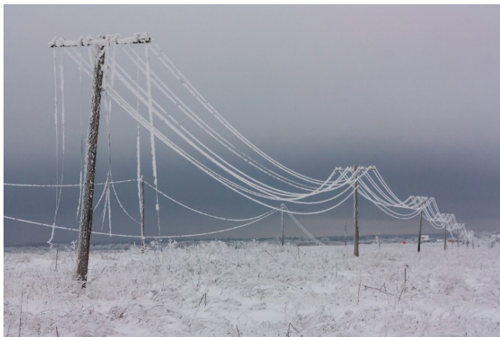
Рисунок 2. Иллюстрация обледенения проводов воздушных ЛЭП и их повреждения
